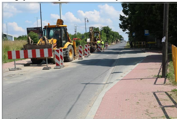
e/ Budowa sieci wodociągowej i kanalizacji sanitarnej do Zamku Królewskiego w Chęcinach wraz z przepompownią wody,
